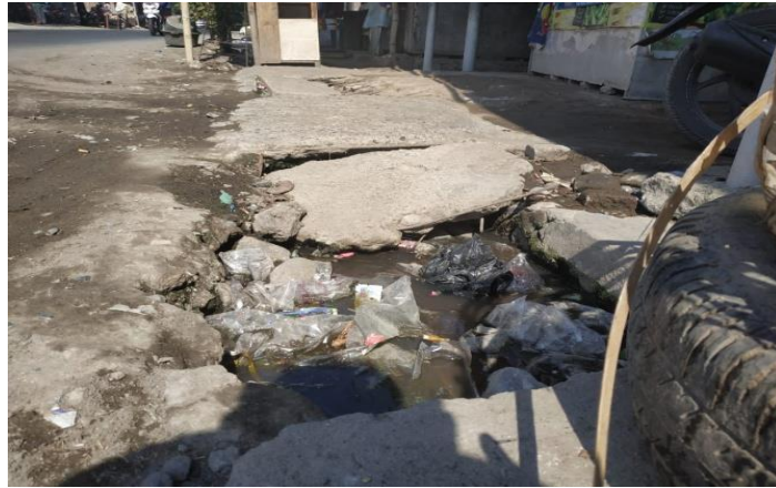
Gambar 2. Perubahan jenis drainase akibat pelayanan depan ruman tidak terkontrol
